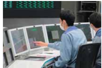
原子炉起動を確認する運転員
